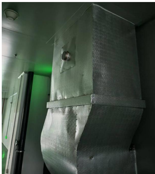
图 7.2-1 DA001 排气筒进口图片
