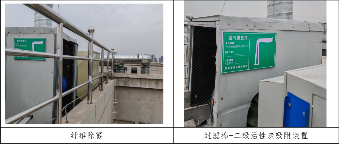
图 4.1.2-2 废气处理设施
