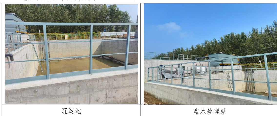
图 5.1.2.1-3 废水处理设施
