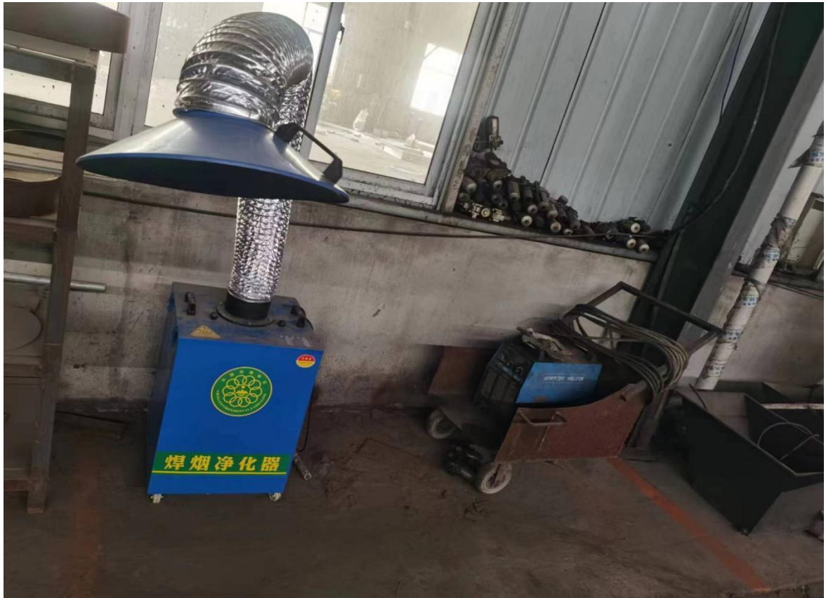
图 4.1-4 废气处理设施
