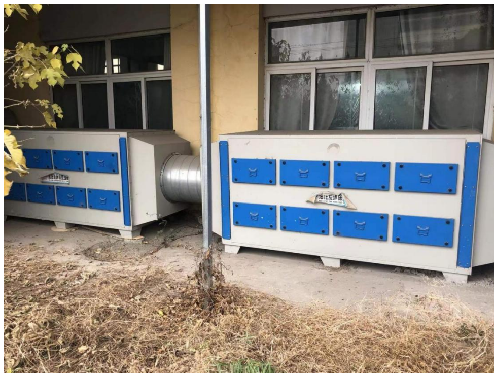
图 4.1-2 项目废气处理设施
