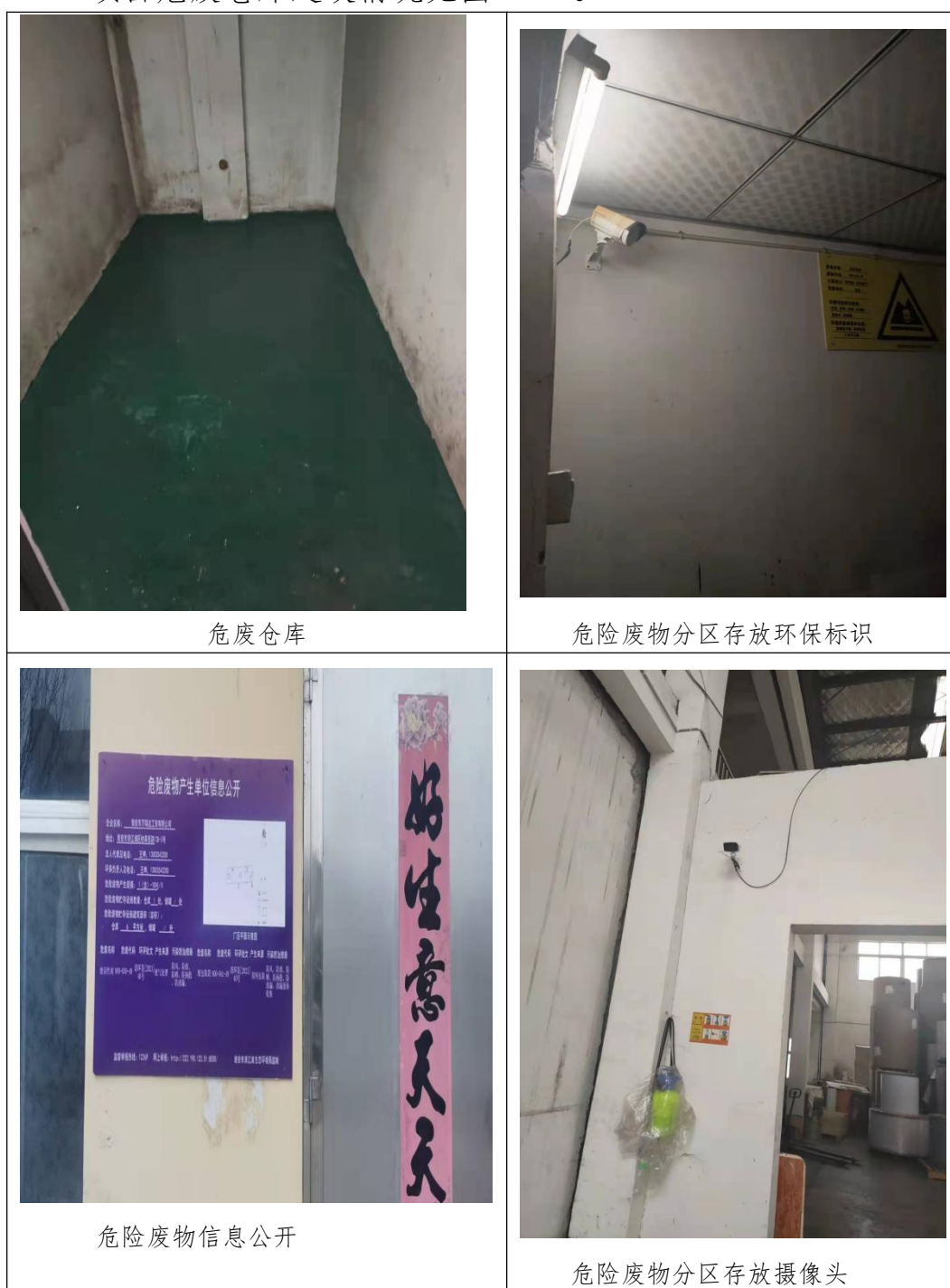
图 4.1-3 淮安市万瑞达工贸有限公司危废库实际建设情况
