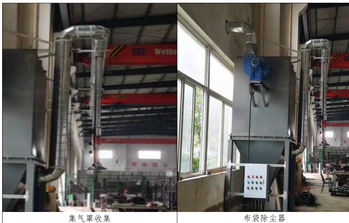
图4.1-2 项目废气处理设施
