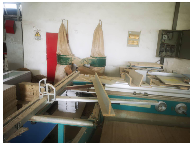
切割机自带除尘设施
