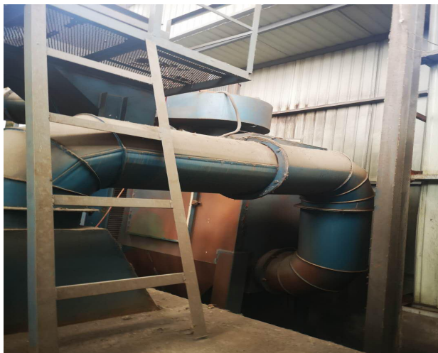
抛丸车间布袋除尘器
