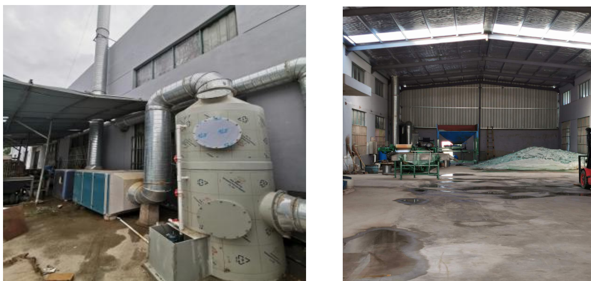
图 4.1-3 项目废气治理设施
